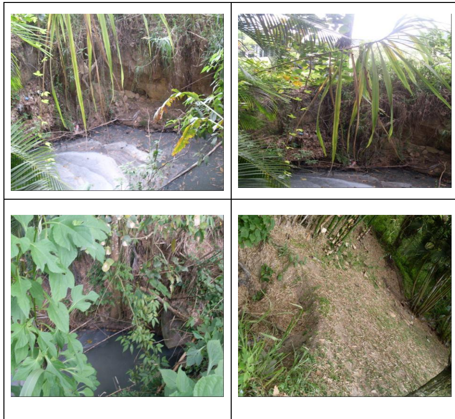
Imagen 6. Acumulación de aguas de lluvia identificada por los vecinos de El Placer. Vista parcial vía principal de la USB, erosión del lugar y tubería descubierta de aguas de lluvias de la USB
